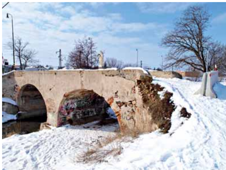
• Most je v dezolátnom stave. Viac ako dva roky je uzavretý. FOTO: Michal Hlavatovič
