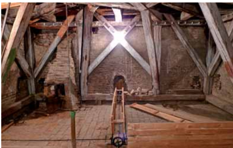
● Mechanické rozvody k ciferníkom pod vrcholom veže.
