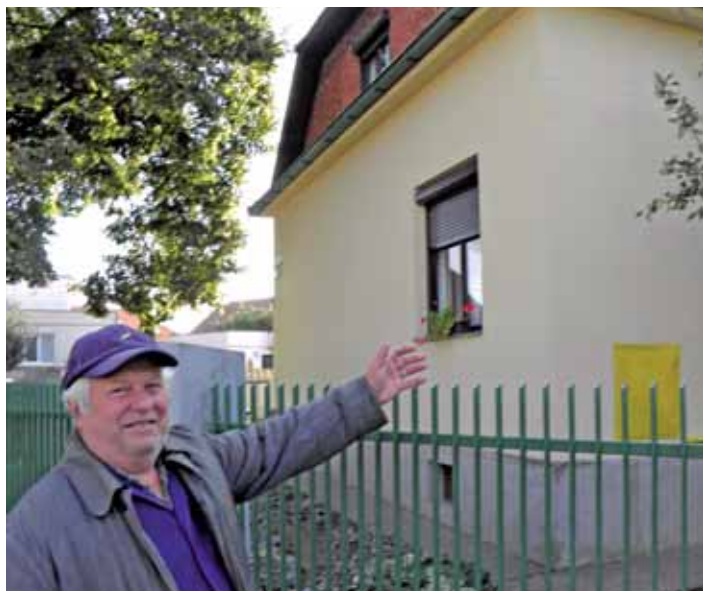
● Na dome Jozefa Kružela od kamiónov popraskala fasáda.
